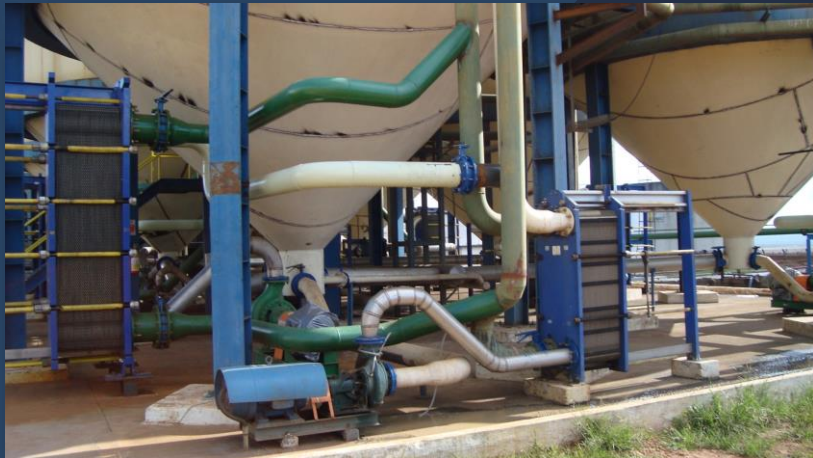
Trocadores de calor para mosto e fermentação
